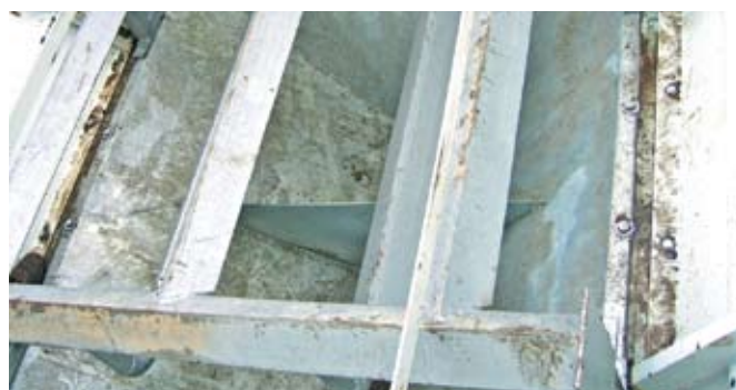
Рис. 3. Диффузоры (фото изнутри одного отсека)
