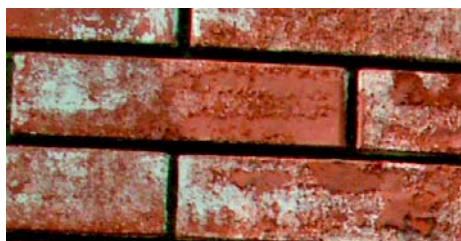
Фото 1. Результат солевой коррозии на фасаде: ровные розовые участки – неразрушенная поверхность керамического кирпича, темные полосы – отшелушивание лицевого слоя, белесые пятна – высолы.
