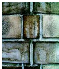
Фото 2. стена из известняка ничем не защищалась (потемнение, вызванное химической коррозией, и следы плесени на камне и в швах)
